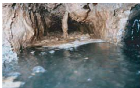
▲下水道管内に油などが付着し、下水の流れを阻害している状況
